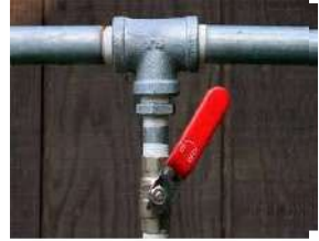
Válvula y tubería de agua
