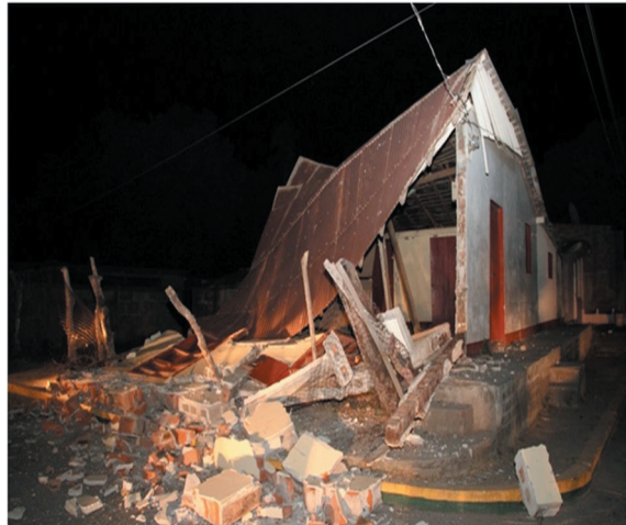
Vivienda destruida por un fenómeno natural (terremoto)
