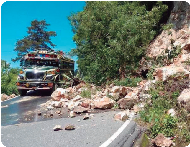
Derrumbes en la vía
