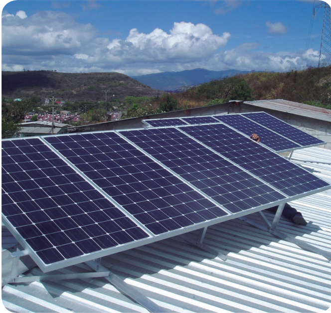
Paneles solares para generar energía eléctrica
