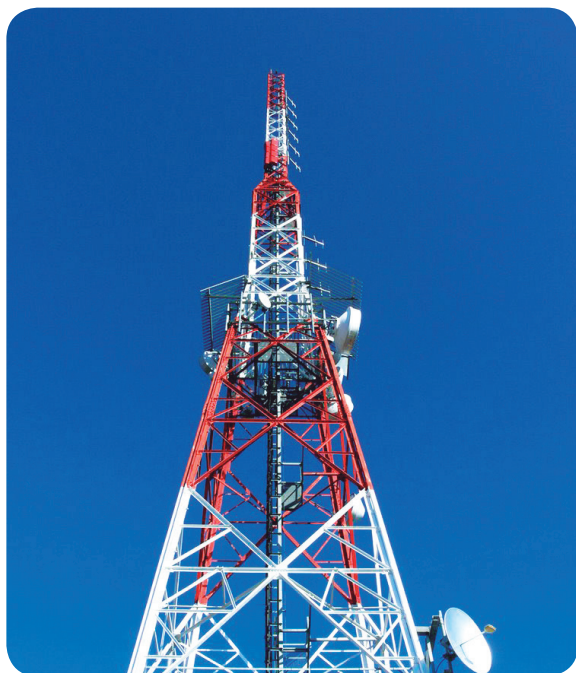
Torre de comunicación
