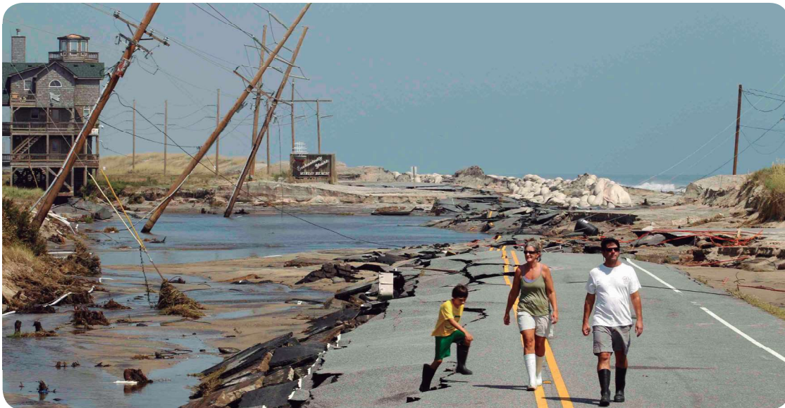
Daños provocados por Huracán Katrina.
